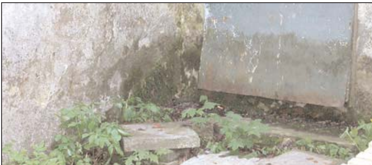
KÄÄRKAMBRI UKSE JUURES OLEVAS PÄIKESE EEST VARJULISES NURGAS ON MAAPIND JA MÜÜR KOORIRUUMI JA KÄÄRKAMBRI KATUSTELT TAKISTAMATULT TULEVA VEE TÕTTU PIDEVALT NIISKED.
