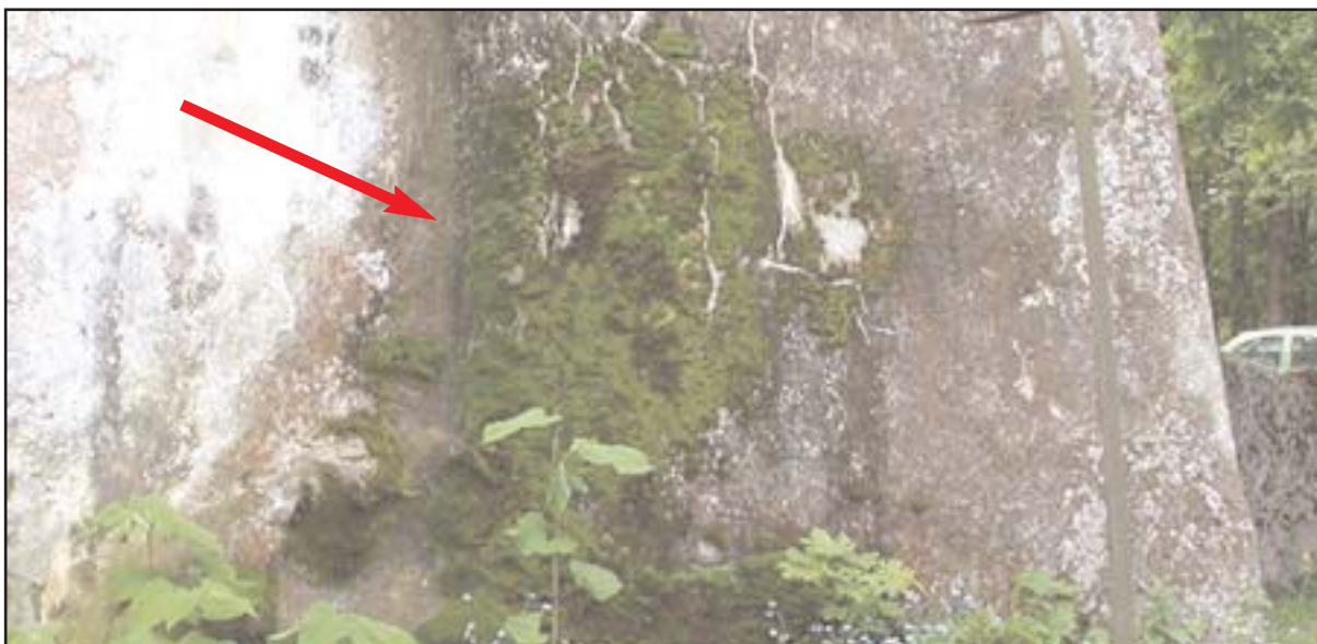
VASAKPOOLSE TUGIPIILARI PÕHJAKÜLG. LIIGNISKUSE TÕTTU ON KROHVI PIND PAKSULT SAMMALDUNUD. MAJASEENE TEKKIMINE KIRIKU SELLES NURGAS OLI TÄIESTI OOTUSPÄRANE.
