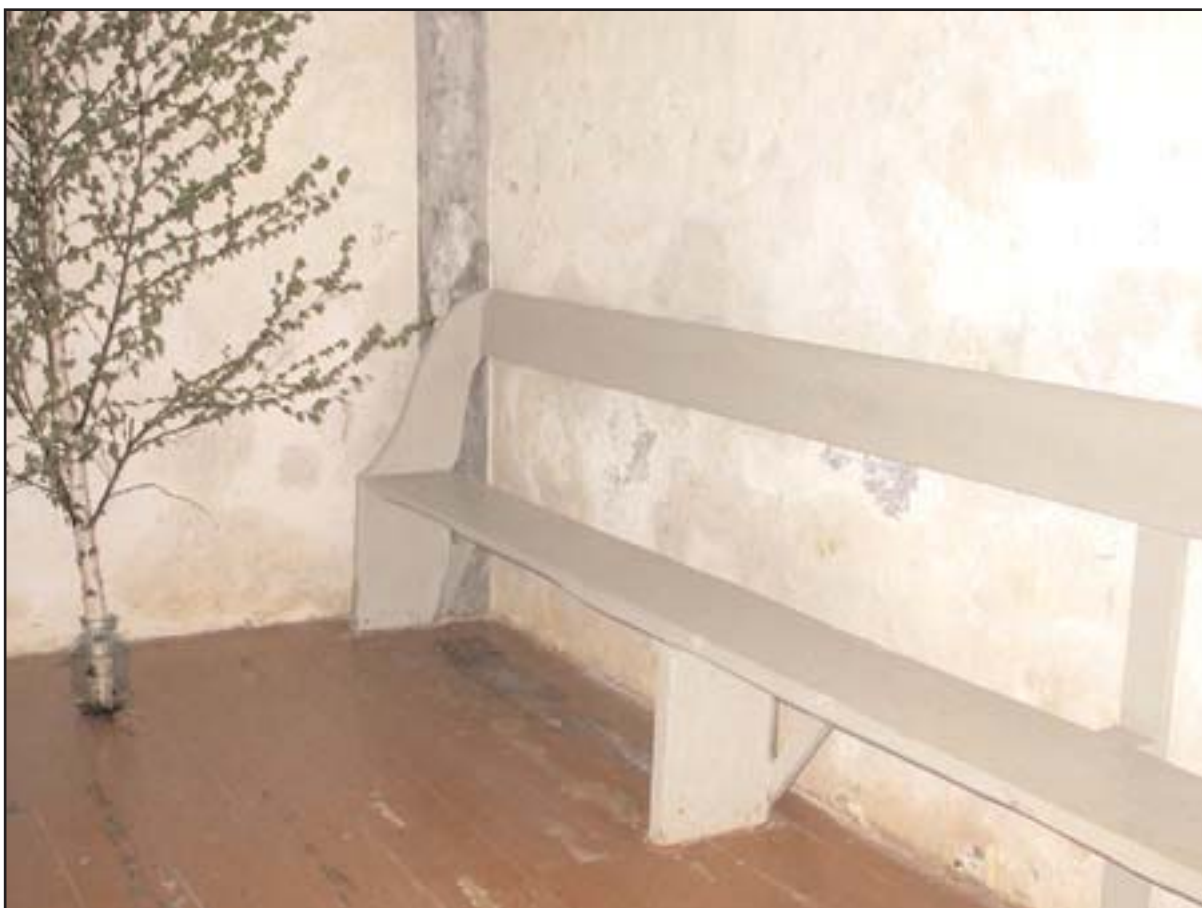
SAMA SEIN SEESTPOOLT. TIHEDATE MÖRTIDEGA TEHTUD KROHVIPARANDUSTE TAHA JA PÕRANDALAUDISE ALLA SULETUD NIISKUS OTSIB VÄLJAPÄÄSU RUUMI POOLE.
