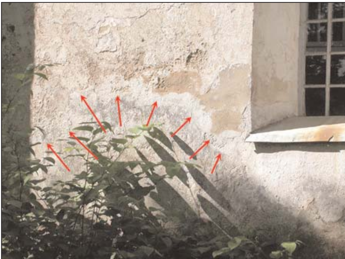
NIISKUSKAHJUSTUSED ON TEKINUD TIHEDA LIIVARIKKA MÖRDIGA TEHTUD KROHVIPARANDUSTEST KÕRGEMAL.
