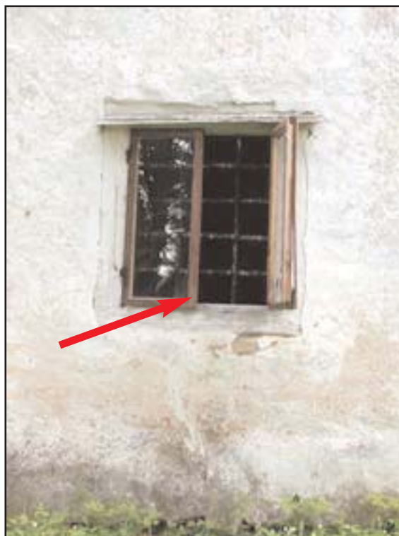
KÄÄRKAMBRI AKNA ALL PUUDUB VEEPLEKK JA VESI JOOKSEB AKNAKLAASIDELT SEINALE.
