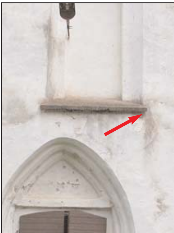
PORTAALI KOHAL OLEVA NISHI KATTEPLAAT ON PAREMALE POOLE VILTU JA SEAL ON SEINA NIISKUSEKOORMUS SUUREM. TELLISMÜÜR IMAB KATTETA KIVIPLAADI NIISKUSE ENDASSE.
