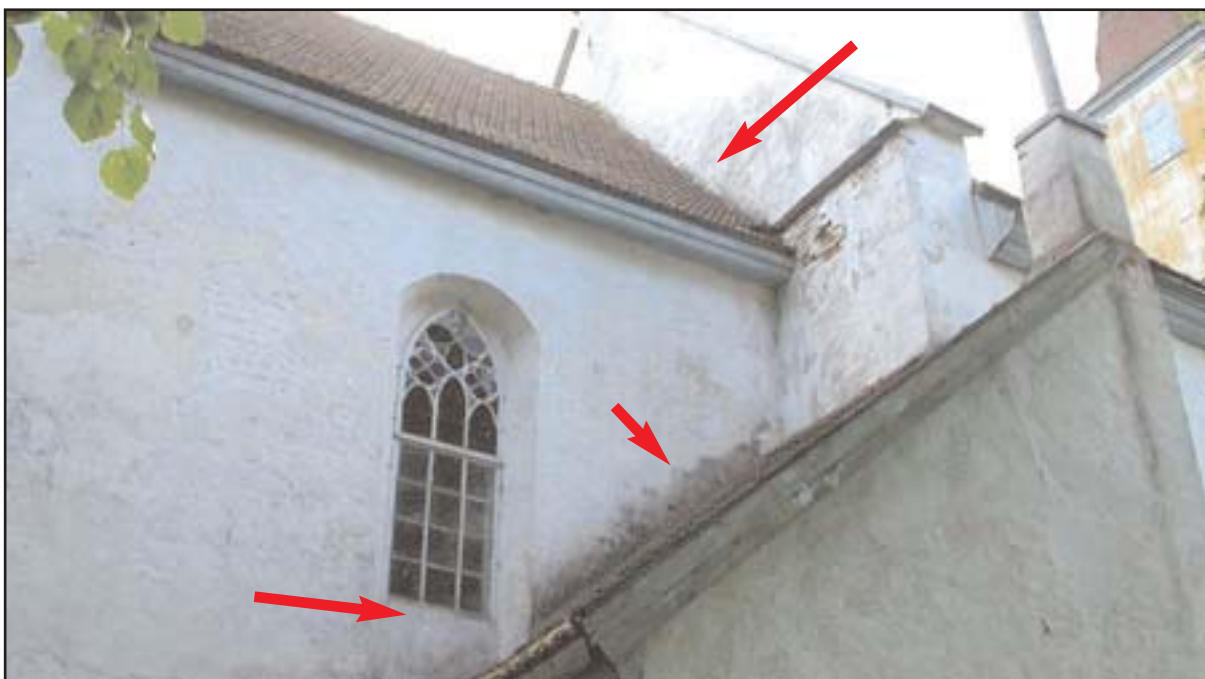
KOORIRUUMI JA KÄÄRKAMBRI KATUSTEL PUUDUB SEINA JUURES PLEKK, MIS TAKISTAKSE VIHMA- JA LUMESULAMISVEEL MÜÜRI SISSE IMBUDA. KOORIRUUMI KATUSE RÄÄSTAST TILKUV VESI PRITSIB KÄÄRKAMBRI KATUSELT SEINA PEALE. KOORIRUUMI AKNA ALL PUUDUB VEEPLEKK JA VESI JOOKSEB SEINA MÖÖDA ALLA.
